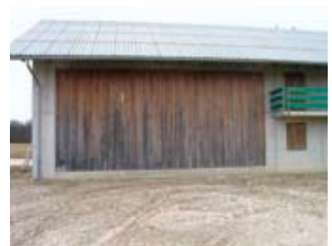
Exposition Nord, thermisch behandeltes Holz, Fichte, sägeroh, Alterung nach 64 Monaten: Starker Schimmelpilzbefall im unteren Bereich.
