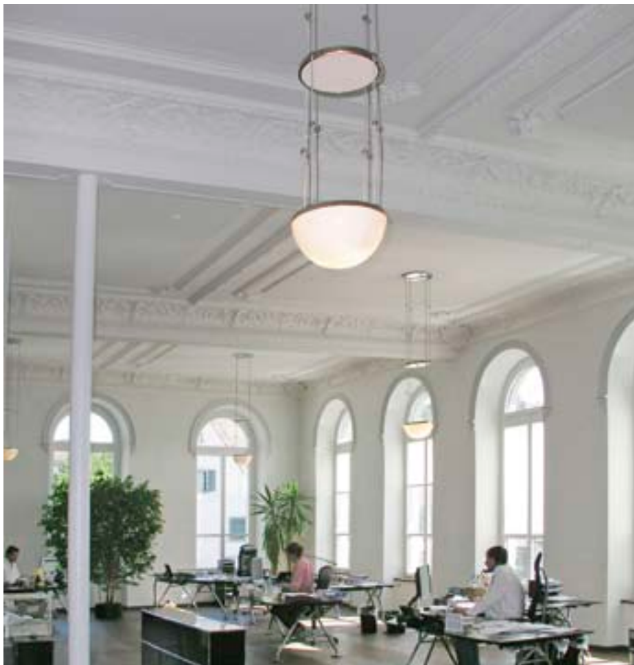
Fertig: Die restaurierte Stuckdecke sorgt für ein ganz besonderes Ambiente im heute als Grossraumbüro genutzten Raum.
