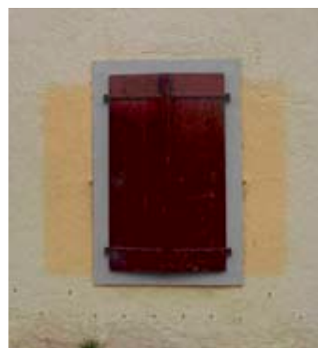
Fensterladen zu, und schon erkennt man, welchen Ton die Fassade ursprünglich hatte.
