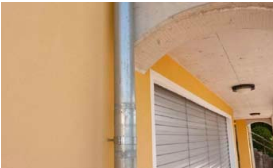
Der Farbton an dieser Aussenfassade in Gordola konnte sich unter dem schützenden Erkervorsprung besser halten als im direkt besonnten Teil.
