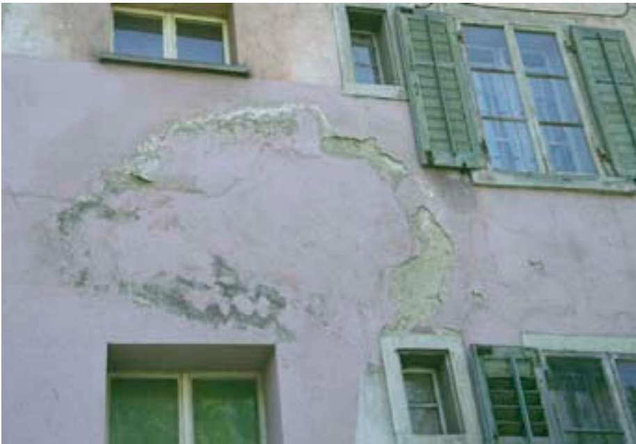
Ausblühungen nach einem Wasserschaden.
