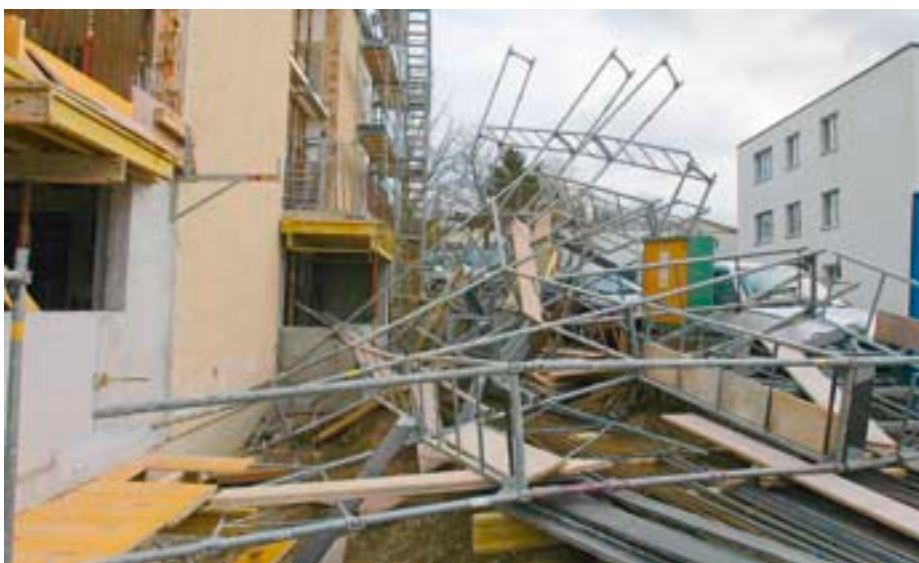
Traurige Folgen eines nicht vorschriftsgemässen Aufbaus eines Gerüsts in Frauenfeld: Ausläufer des Sturmes Kyrill brachten es im Januar 2007 zum Einsturz. Der Gerüstarbeiter wurde auf die Strasse geschleudert und blieb verletzt liegen.
