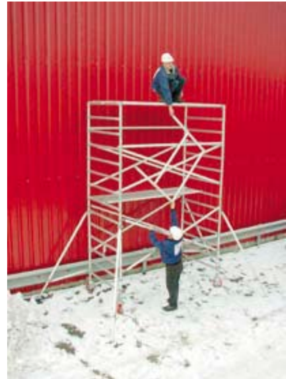
Typische Gefahrensituation: Während der Montage fehlt der Seitenschutz.
