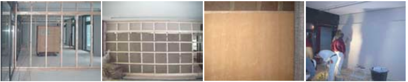
Die Unterkonstruktion der Trennwände besteht aus 80 mm starken Nadelhölzern und einer Dämmung mit nachhaltigem Flachs. Darauf wurden die 25 mm starken, 62,5 x 150 cm grossen Lehmplatten mit Schilfkern geschraubt, anschliessend zwei Schichten Lehmfeinputz aufgetragen und die Oberfläche gescheibt. (Bilder: Lanatherm)
