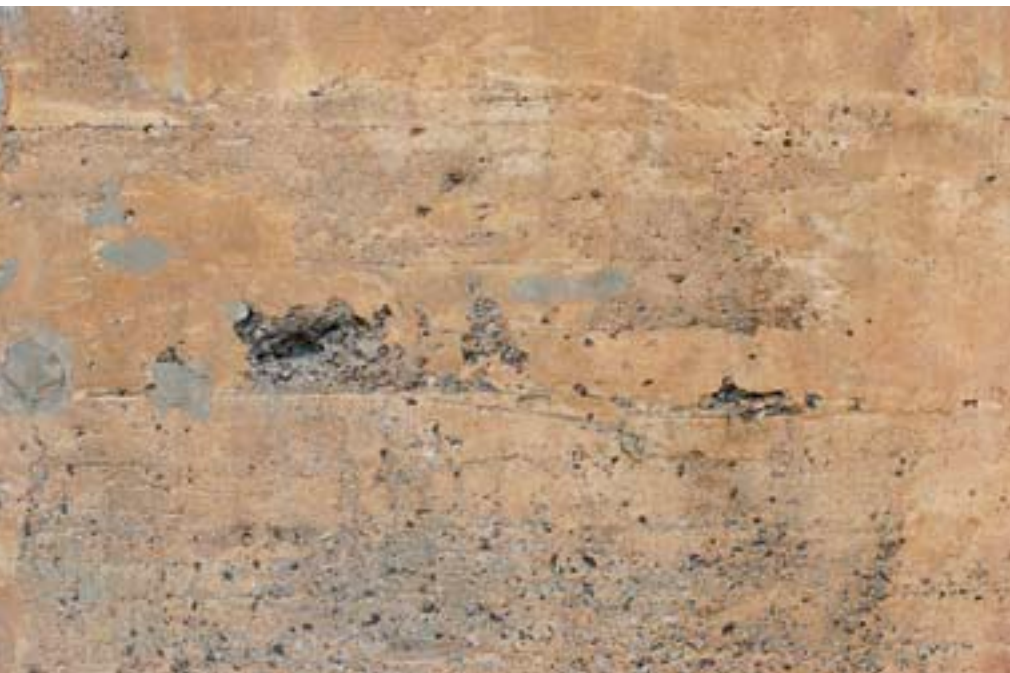
Une mesure préventive: Reboucher préalablement les grosses fissures.
