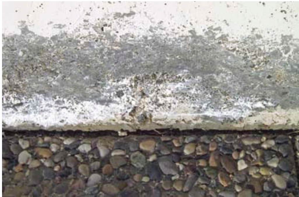
Les zones au sol exposées aux projections d'eau sont particulièrement touchées par les efflorescences. (Photo: Heinz Kastien)
