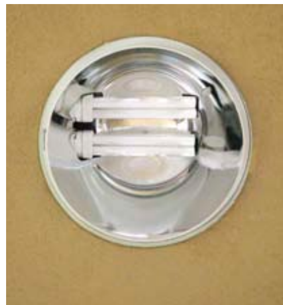
In Lehmplatten sind runde Ausschnitte eine Herausforderung. Für exakte Ränder wurden die Platten quadratisch ausgeschnitten, vorgefertigte Leuchtelemente inklusive Schattenfuge eingesetzt und verputzt. (10)
