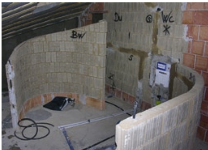
Gebrannte Ziegel am Fuss des Lehms und abschliessend ein gefliester Sockel verhindern Stauässe.
