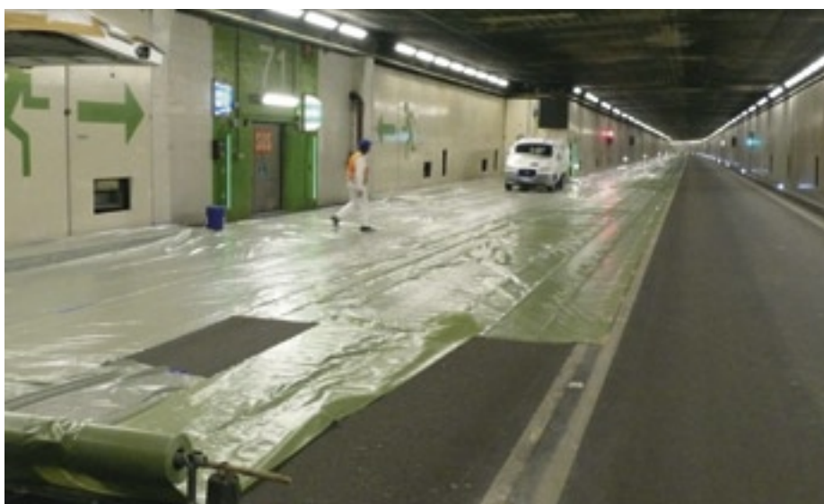
7'000 Quadratmeter Folie: Auf rund 800 Metern deckten die Arbeiter die Fahrbahn mit Folie ab.
