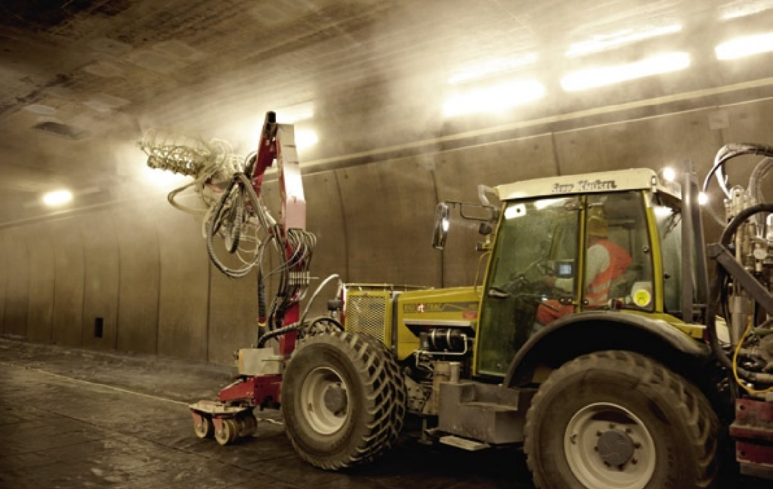
Auf der Nordseite arbeitete das Maler- und Gipsergeschäft Trauffer mit seiner Hochleistungs-Tunnelbeschichtungs-Maschine.
