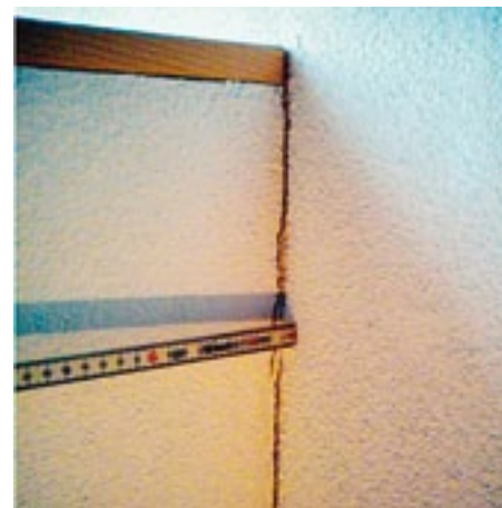
Abbildung 6: Beim T-Anschluss der Treppenhaus-Brüstung an die tragende Holzwand hat sich ein Riss in der Innenecke gebildet.
