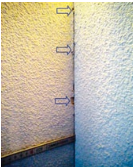
Abbildung 4: In diesen Innenecken fehlen Dehn- und Stauchzonen, welche die Verformungen schadensfrei aufnehmen könnten.
