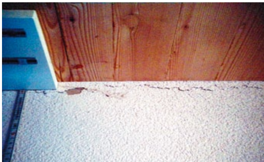
Abbildung 3: Die Zone unmittelbar unter dem Wand-/Deckenanschluss ist anfällig für Abplatzungen und Abscherungen infolge Einfederung und/oder Deformationen der Decke.
