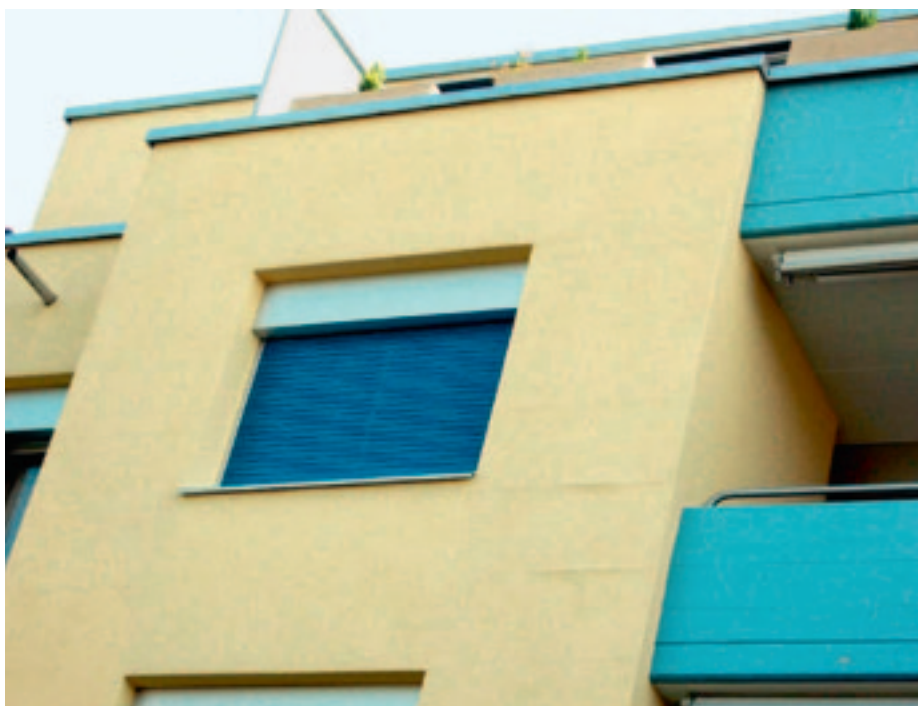
Risse im Aussenputz: Spätestens jetzt sollte eine Fassadensanierungsvariante in Betracht gezogen werden.
