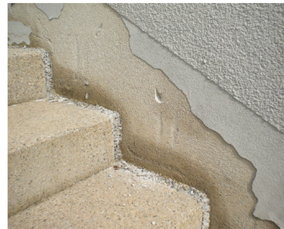
Sieht man oft: Putzschaden im Sockelbereich durch aufsteigende Feuchtigkeit infolge fehlender Schutzmassnahmen. (Bild: Walter Schläpfer)
