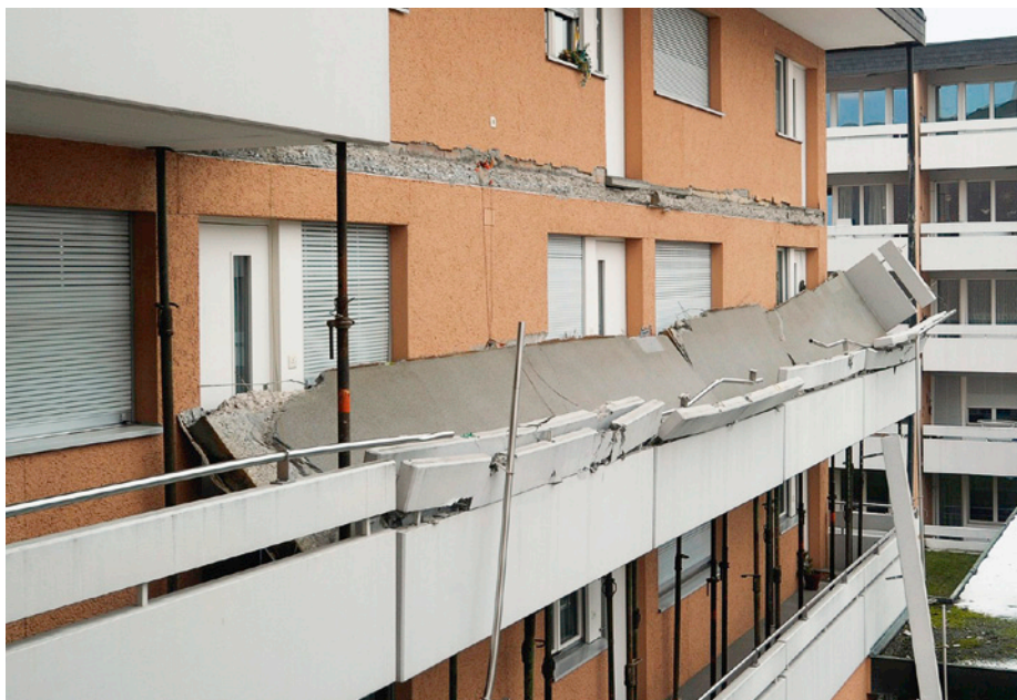
Der Laubengang eines Altersheimes, welcher am Mittwochabend, 29. Dezember 2010, vom 2. auf den 1. Stock gestürzt ist, aufgenommen am Donnerstag, 30. Dezember 2010, in Uster. Am Gebäude entstand ein Sachschaden von mehreren hunderttausend Franken, verletzt wurde niemand. (Bild: Steffen Schmidt, Keystone)
