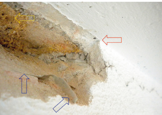
Wand-Decken-Anschluss mit eingebautem Gleitlager, aber fehlender Dehn- und Stauchzone. (Bild: Walter Schläpfer)
