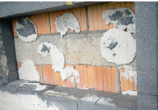
Hier wurden Wärmedämmplatten mit einem ungenügenden Klebeverfahren appliziert. (Bild: Walter Schläpfer)
