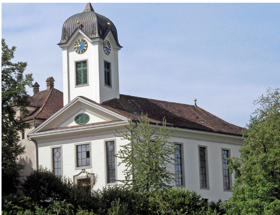
Die Schlosskirche Grüningen wurde 2011 saniert und mit MonoSilikat von Sax beschichtet. Die Arbeiten hat SMGV-Mitglied Roger Widmer ausgeführt. (Bilder: Sax-Farben AG)
