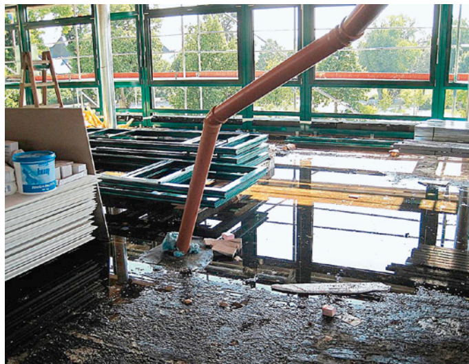
Kaum zu glauben, aber Realität: Die Leichtbauwände liegen bereits zum Einbau parat, der Bau selbst ist noch völlig durchfeuchtet.
