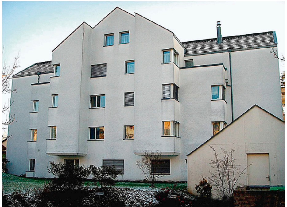
Gebäude ohne konstruktivem Fassadenschutz (Dachüberstand).
