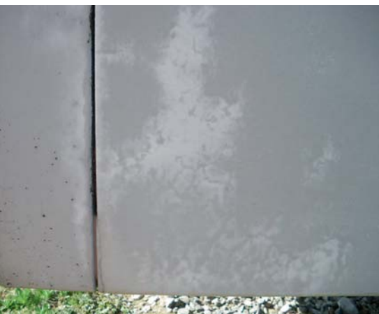
Efflorescenze su un balcone.
