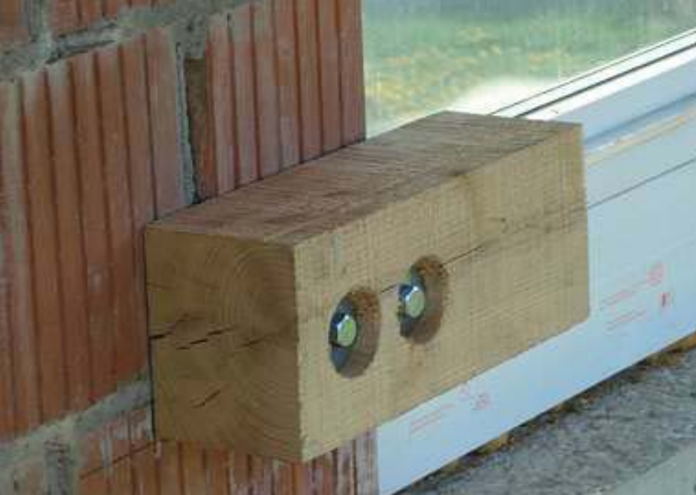
Improvisierte Lösungen auf der Baustelle.
