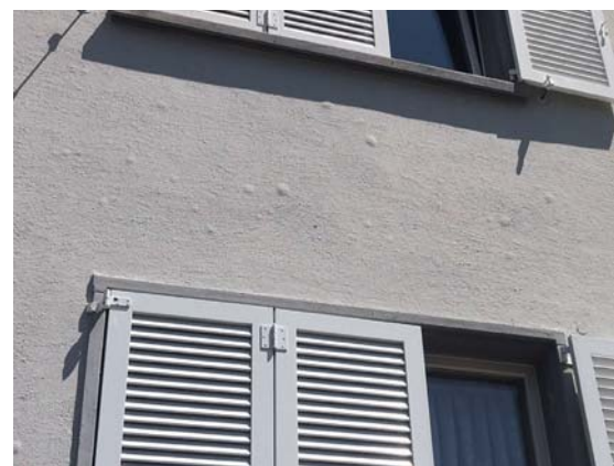
Blasenbildungen wegen zu hohen Dampfdiffusionswiderstands als Folge eines neuen Fassadenanstrichs.
