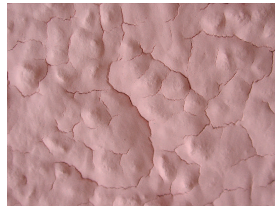
Fessurazioni nella pellicola di vernice (prima mano).
