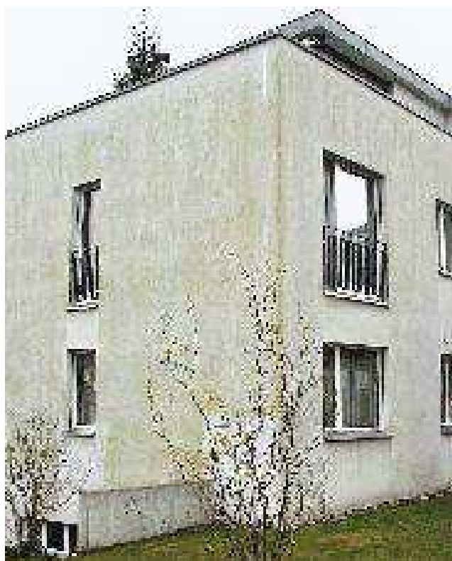
Tauwasser ist die Lebensgrundlage von Algen an der Beschichtung. (Bild: zVg)
