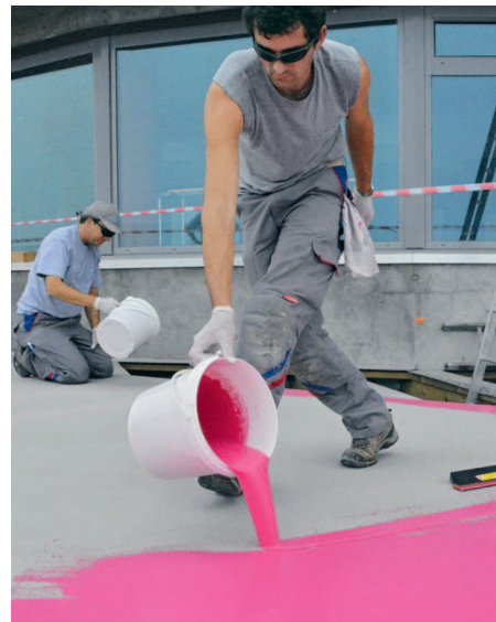
Applikation einer Kunstharzbeschichtung auf Holz, Beton und verzinktem Stahl (rechts). Es entsteht eine rutschfeste, dynamisch rissüberbrückende Beschichtung als «Eye Catcher» (links).
