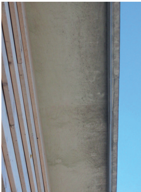
Schadensbild beim nördlichen Dachüberstand.
