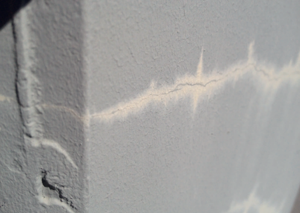
Ausblühungen treten bevorzugt im Frühling und Herbst auf.
