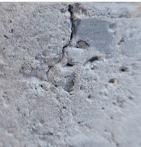
Abb. 6: In den Riss teilweise eingedrungene Beschichtung.
