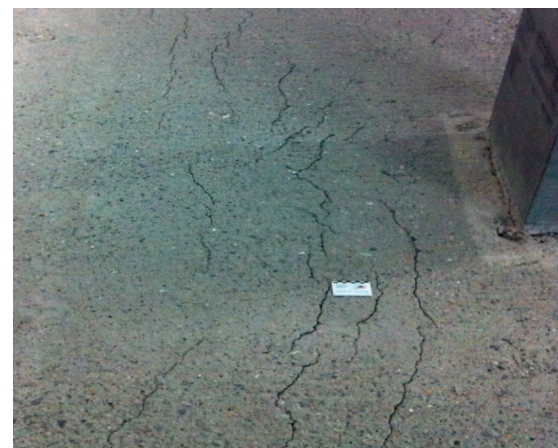
Schwindrisse in einem Garagenboden.
