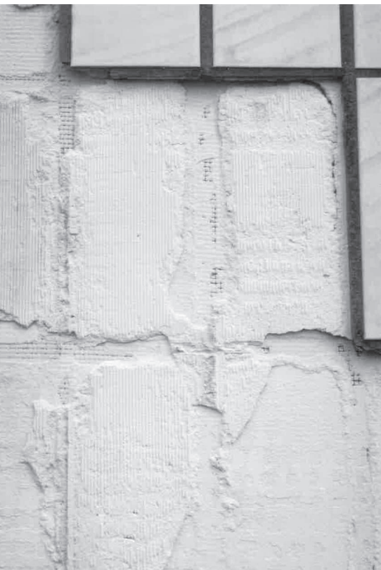
Teilansicht des Frostschadens: Es ist deutlich zu erkennen, dass die Frostschädigung im Bereich der Mörtelfugen, durch die Regenwasser eindringen kann, am stärksten ist.
