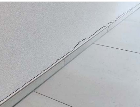
Abb. 16 und 17: Ablösung der Sockelplatte.
