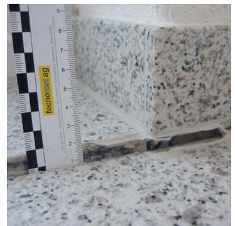
Abb 14: Absenkung (Stolperfalle) bei Türschwelle.
