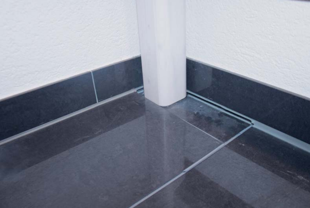
Abb. 18: Drei Folgen der Absenkungen: Links: Platte aus Klebemörtel abgelöst; Mitte: Fugendichtungsmasse gerissen; Rechts: Fugendichtungsmasse stark gedehnt.
