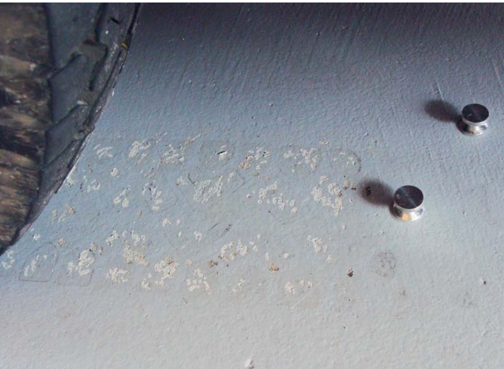
Ablösungen im Fahrspurbereich.
