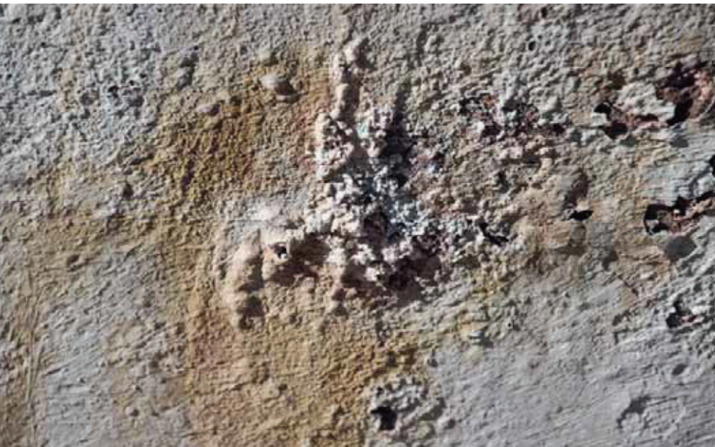
Feuchtigkeits- und Salzaufstieg in einem Mauerwerk.
