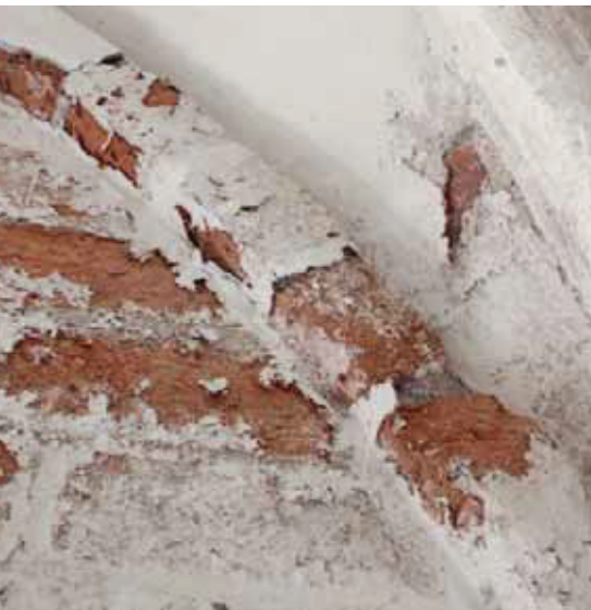
Salzschäden durch Auftausalze.
