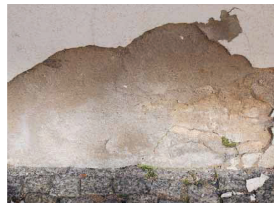
Salzausblühungen auf einer Oberfläche.
