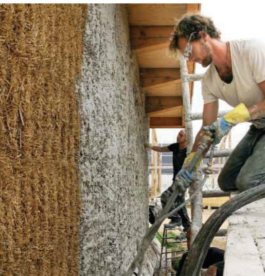
Bilder auf dieser Seite: Das Dämmen mit Stroh ist energieeffizient, das Ergebnis optisch attraktiv. (Bilder: Gräfix)
