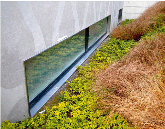
Vorprogrammierter Schaden: Der Überstand der Zarge beim Sturz wirkt als wasserführende Ebene. Die Bewegungsfuge rund um die Zarge fehlt.
