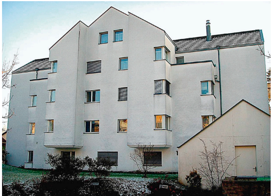
Gebäude ohne konstruktivem Fassadenschutz (Dachüberstand).
