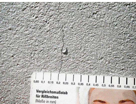
Ist dieser Riss noch im Bereich der Toleranz? Der Massstab sagt nein.
