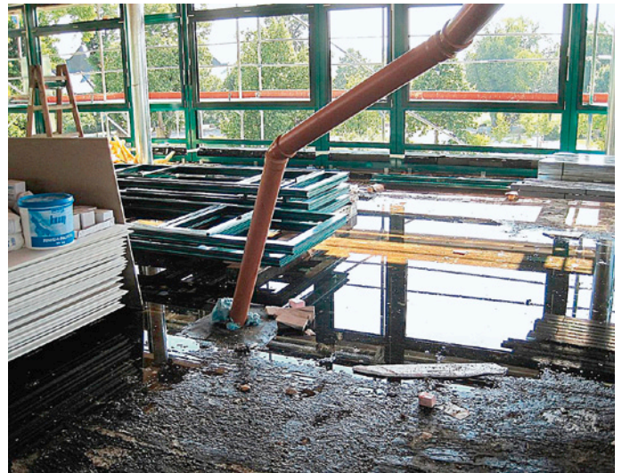
Kaum zu glauben, aber Realität: Die Leichtbauwände liegen bereits zum Einbau parat, der Bau selbst ist noch völlig durchfeuchtet.
