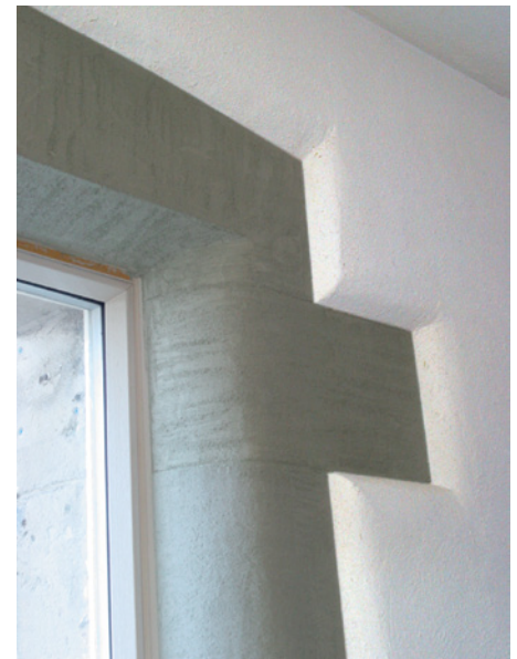
Wärmebrücken gestalten: Die Laibung erhielt einen Dämmputz, der den Naturstein ästhetisch nachzeichnet. So gut wie die anschließenden Mineralschaumplatten dämmt er nicht. (Bild: Achim Pilz)
