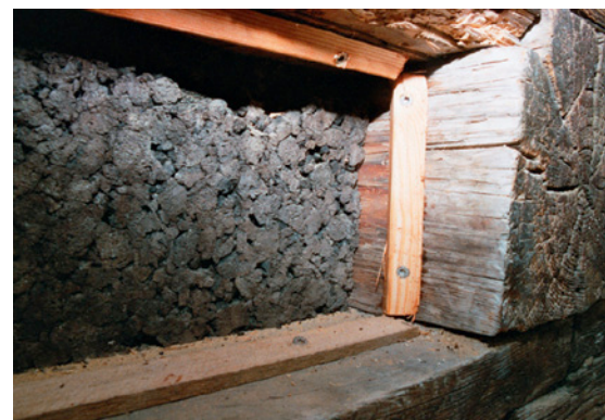
Bei Mauerwerks- wie bei Fachwerkbauten sind einbindende Balkenköpfe kritische Stellen. Besonders beim Fachwerk besteht die Gefahr, dass sie von aussen feucht werden. (Bild: Rolf Canters)
