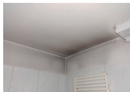
Dunkle Verfärbungen, sogenanntes Fogging, überall in der Wohnung.
