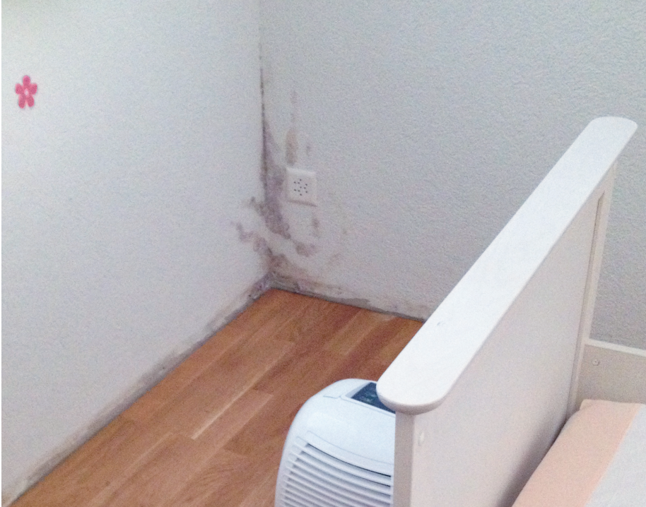
Bild 10: Haus 2, Wohnung im EG mit Schimmelpilzbildung.
