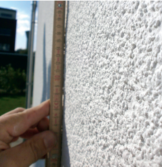
Bild 3: Beispiel für die Aufwölbung des Deckputzes.
