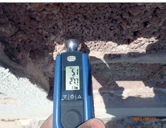
Bild 7: Das Feuchtemess- gerät GANN-Hydromette zeigte 4,6 bis 5,1 Masse- prozent Feuchtigkeit.
